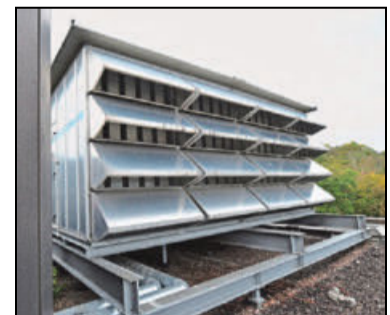
Auf dem Dach sind die Lüftungsanlagen zu sehen.
