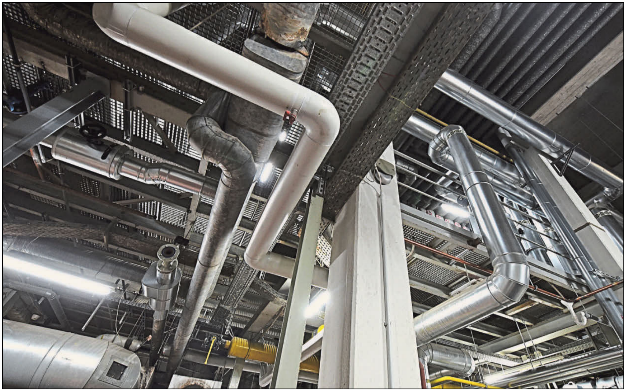
Diesen Anblick bekommt kein Patient zu sehen: Das WESTFALEN-BLATT hat mit dem Technikteam hinter die Kulissen geschaut und einen Einblick in die Abläufe gewonnen. Von der Lüftung, der Stromversorgung bis zum Abwasser auf den acht Etagen – regelmäßig wird in moderne Lösungen investiert. Fotos: Harald Iding
