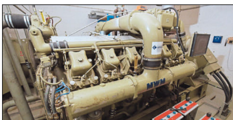
Als Stromreserve steht ein Dieselmotor mit 800 PS bereit.
