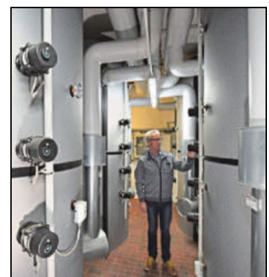
In diesen Not-Tanks wird Wasser elektrisch aufgeheizt.
