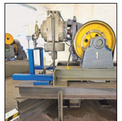
So sieht ein Teil der Technik für die Aufzüge im Haus aus.
