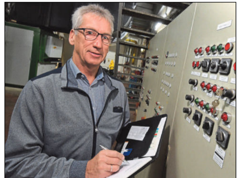
Kontrolle ist ein Muss, damit der Großbetrieb Krankenhaus funktioniert: Der 62-jährige Norbert Henke leitet das Technik-Team.
