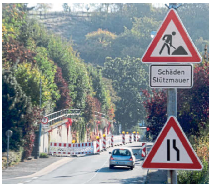
Sanierungsbedürftig: Die Stützmauer an der Ortsdurchfahrt Bödexen soll eigentlich in diesem Jahr wieder in Stand gesetzt werden. Getan hat sich bisher nichts. FOTO: DAVID SCHELLENBERG
