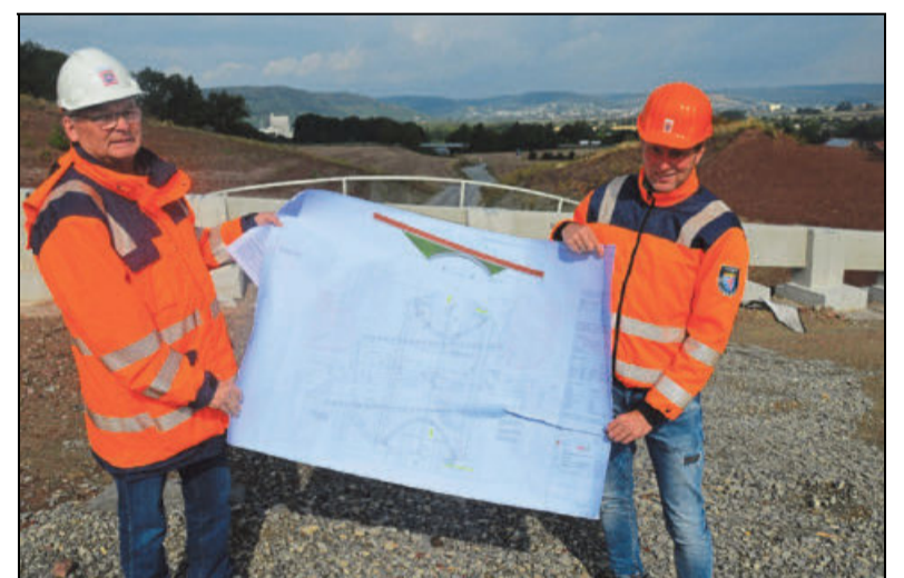
Die Straßenplaner Stephan Nolte (links) und Michael Seidel beziehen demnächst ein Containerbüro direkt an der Baustelle.
