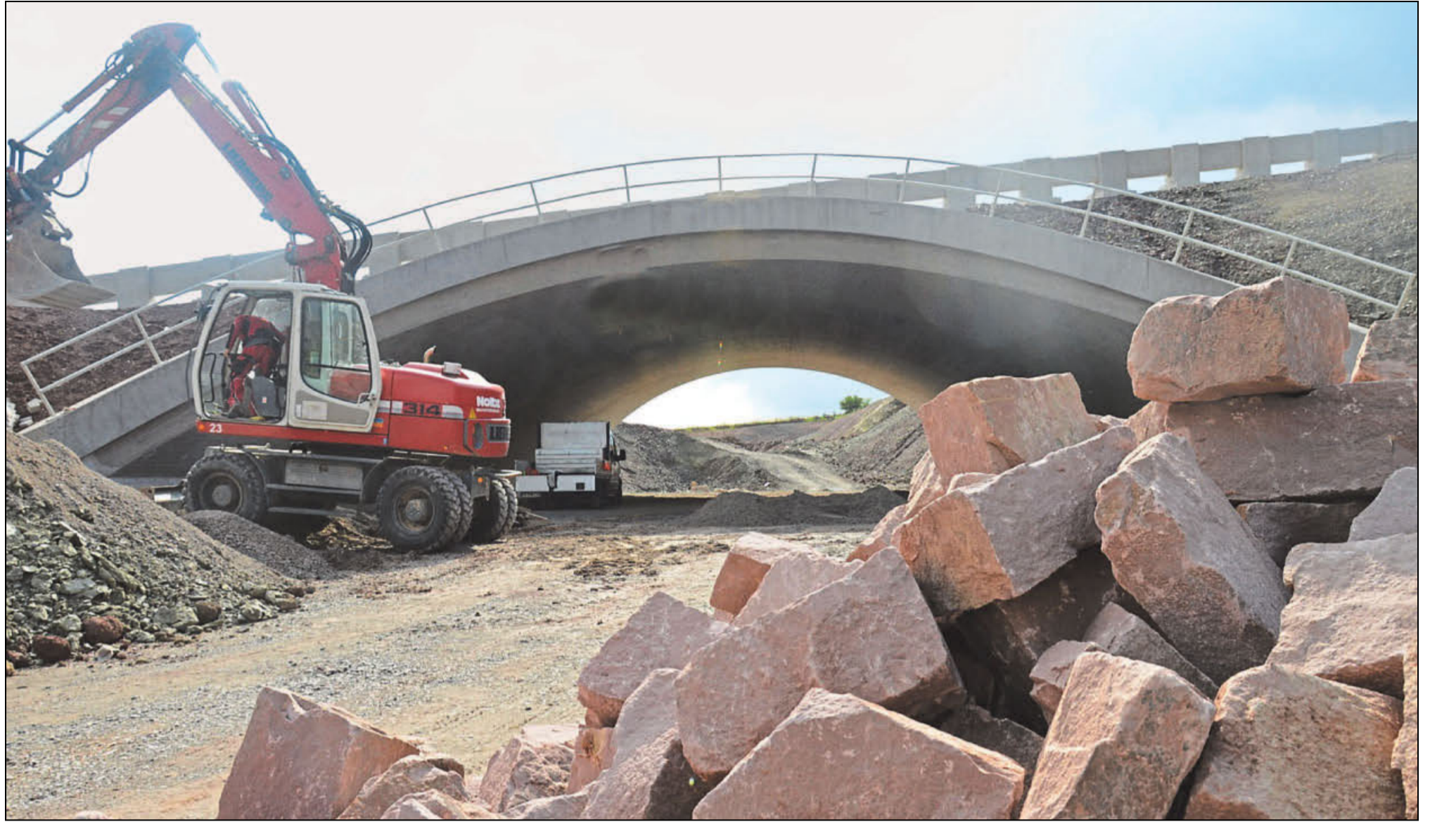
Derzeit sind die Bauarbeiten rund um die Brücke »Schiewe Halbe« bei Herstelle noch in vollem Gange. Auf die Betonpfeiler auf der Brücke werden Holzwände gebaut, die Fledermäusen eine sichere Überquerung der B 83 ermöglichen sollen. Die Irritationschutzwände werden in den kommenden Wochen errichtet. Fotos: Marius Thöne
