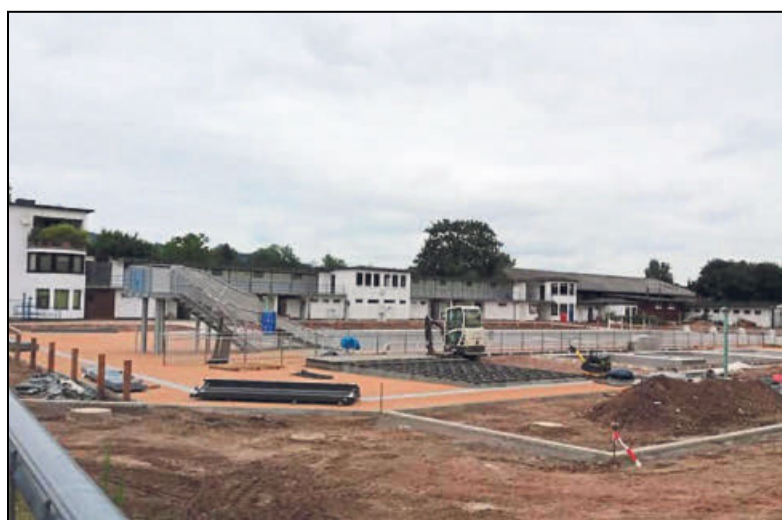
Die Arbeiten am Freibad gehen aufs Ende zu. Ende Juli wird aber wohl nicht mehr eröffnet. Foto: Michael Robrecht
