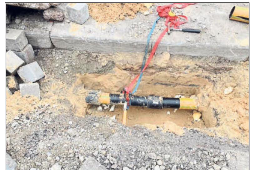
Ein Bagger hat bei Bauarbeiten im Rohrweg eine Gasleitung beschädigt. Sie konnte schnell repariert werden. Foto: Feuerwehr
