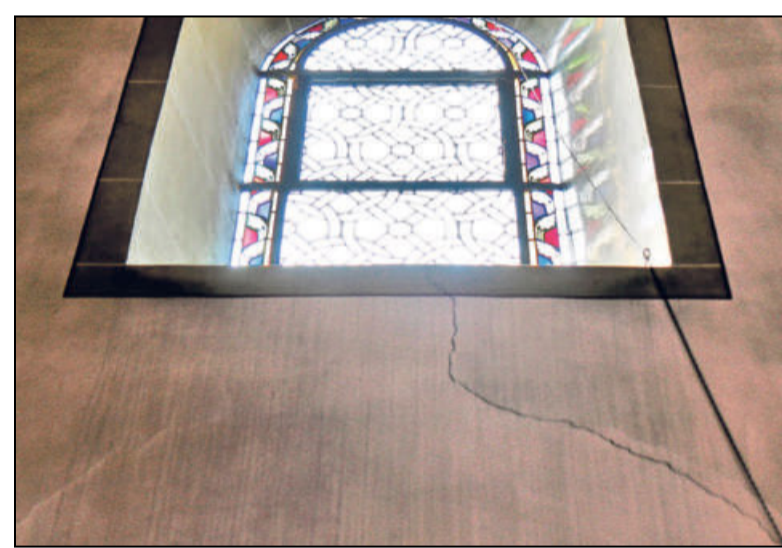
Sanierungsbedürftig: Risse im Putz zeigen den schlechten Zustand der Heilig-Kreuz-Kirche in Ottbergen.
