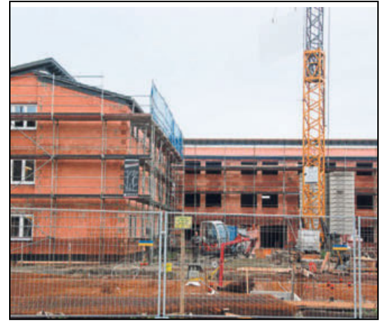
An der Lütmarser Straße werden drei neue Flüchtlingsheime neben der Realschule gebaut.
