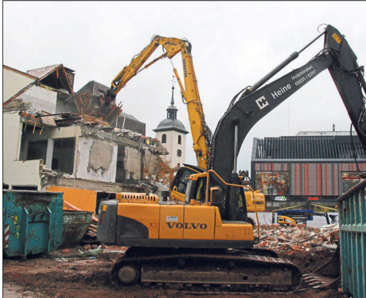
Für 14 Millionen Euro wird der Marktplatz Süd in Höxter mit Wohn- und Geschäftshäusern neu bebaut. Die 60er-Jahre-Altbauten sind abgerissen worden. Investor Fokus hat zuvor schon das Hertie-Haus umgebaut.
