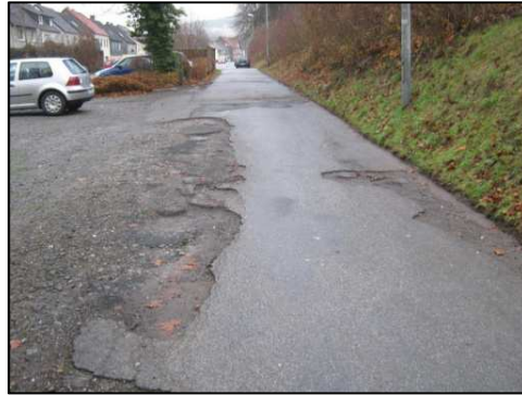
Abb. 26: Am Petriwall (Belagsschäden)
